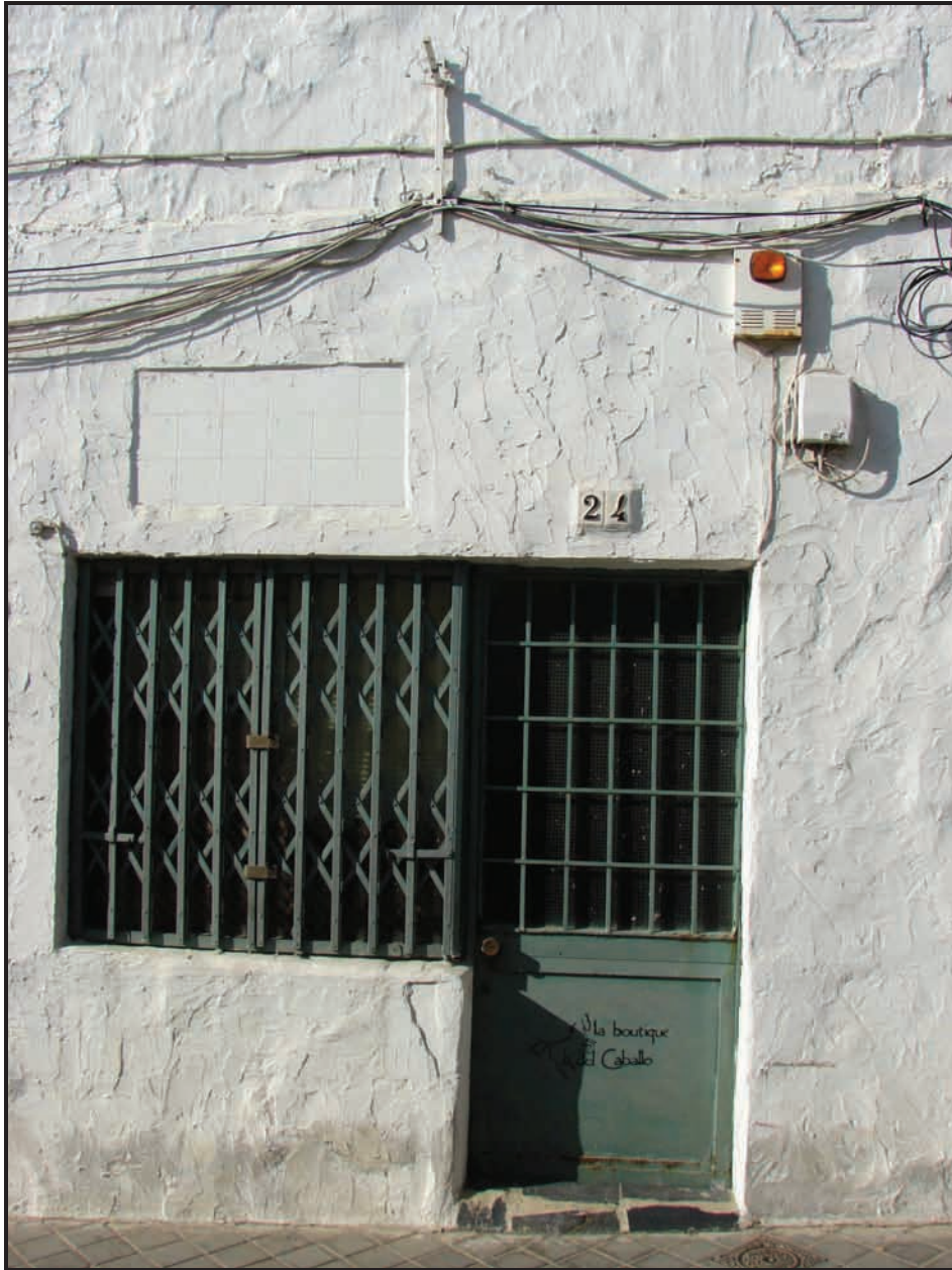
Foto 5. Detalle de la fachada modificada para escaparate y acceso a una antigua tienda. Ostenta el número 24, pero aunque se corrobora con el parcelario no existe una subdivisión de la parcela. Obsérvese la contaminación visual de los cables y la alarma antirrobo.
