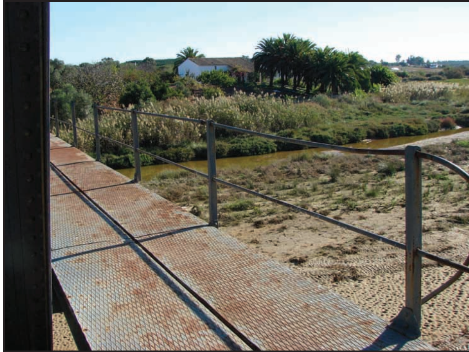
Foto 5. Detalle del estado de conservación de las barandillas laterales del puente, alguna de ellas dobladas y otras arrancadas.
