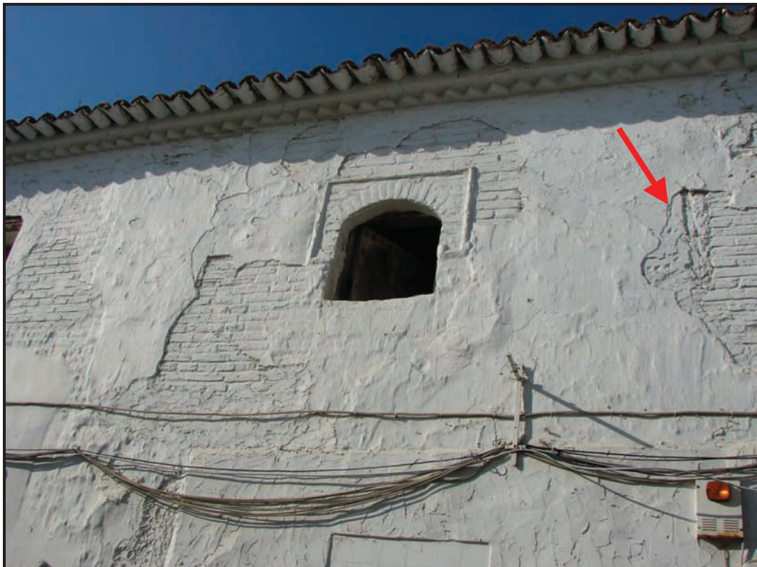
Foto 2. Detalle de ubicación del “alfiz” en la fachada. Obsérvese la contaminación visual de los cables y la disgregación y pérdida del enfoscado. Gracias a dicha pérdida puede observarse otro hueco original (cegado a posterioridad) junto al alfiz.
