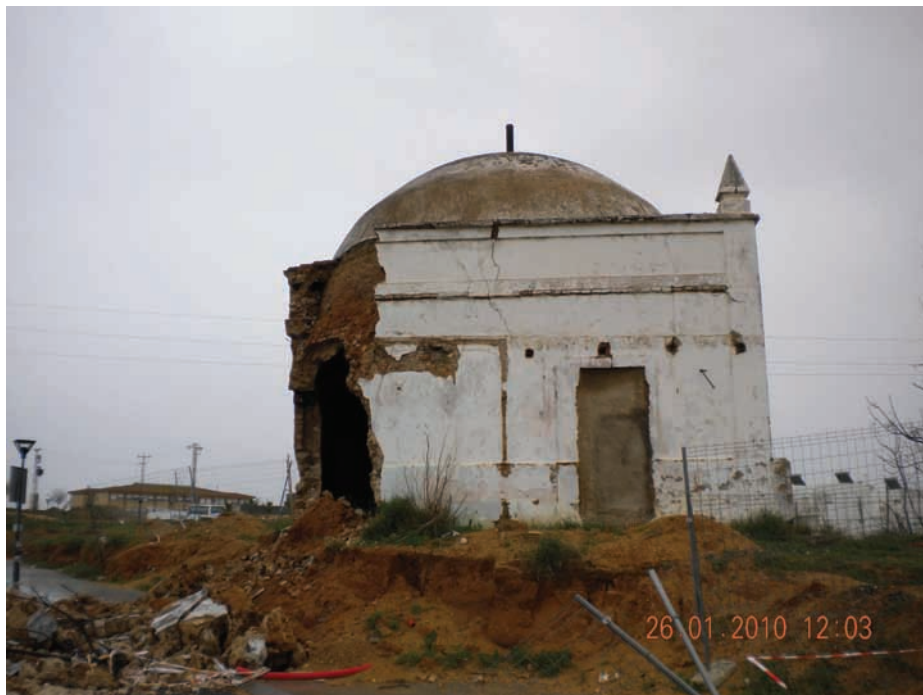
Foto 4. Detalle del derrumbe parcial del inmueble.
