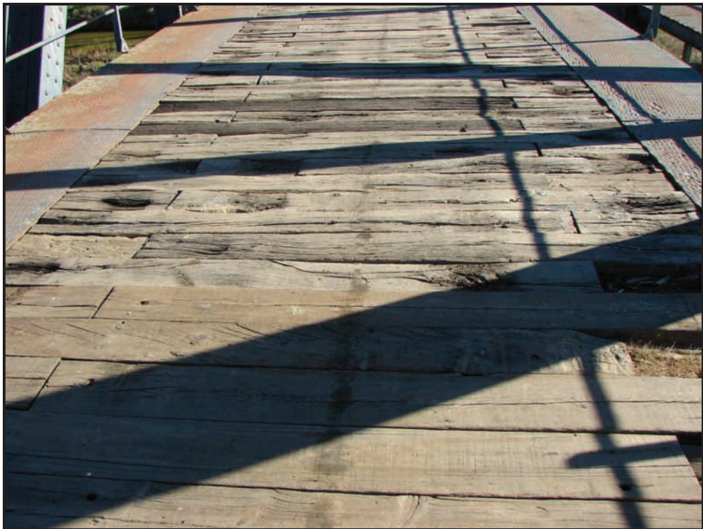
Foto 4. Detalle del estado de conservación de las planchas de madera que constituyen el entablamento actual del puente.
